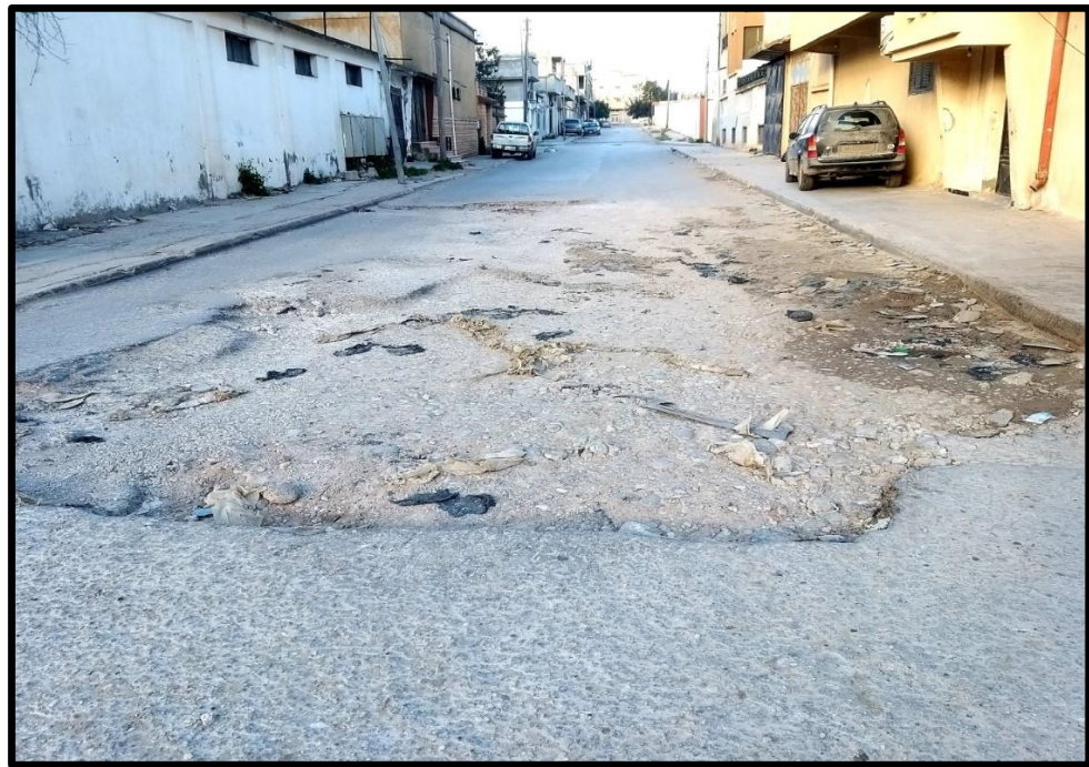
الشكل (3) وجود حفر بأحد طرق مدينة القبة
